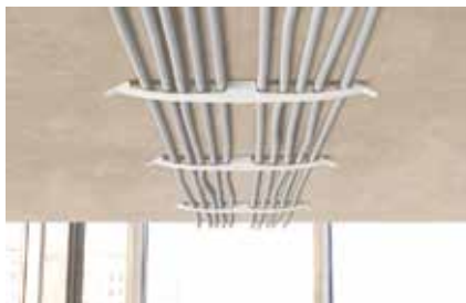
Upevnenie káblových zväzkov
