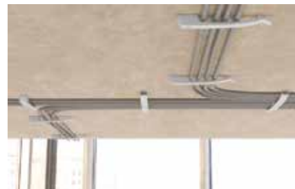
Upevnenie káblových zväzkov
