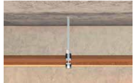
Zavesenie jednotlivých potrubí
