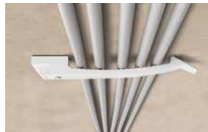
Upevnenie káblových zväzkov
