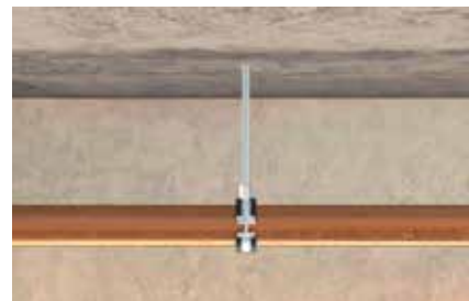
Zavesenie jednotlivých potrubí
